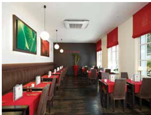
Αναρτώμενες μονάδες οροφής
